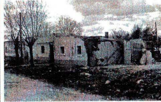
Casas destruidas por los fuertes vientos
